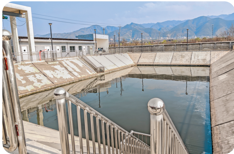
▲南山污水泵站
